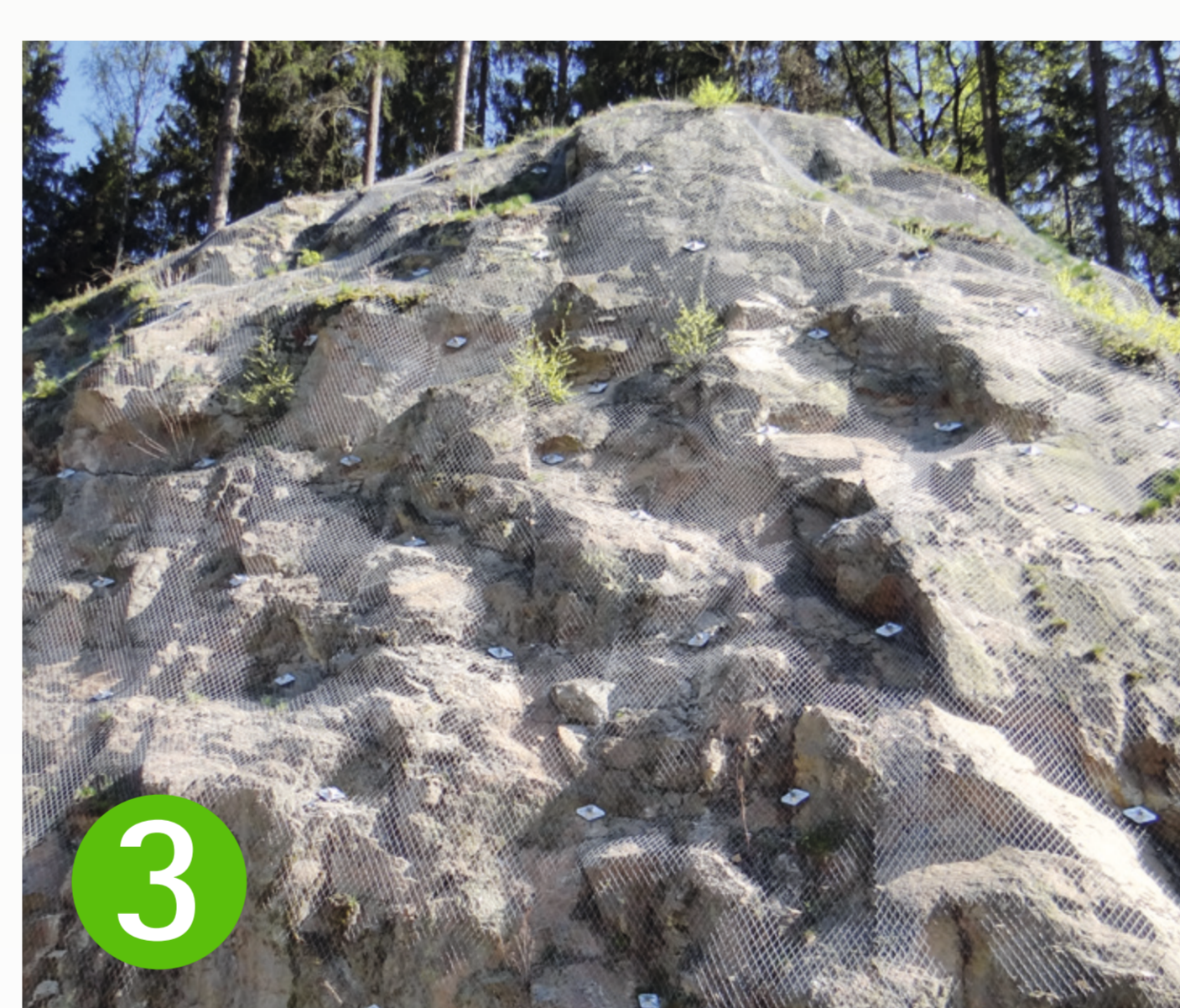
3 Einzelblocksicherung mit Steinschlagschutznetz
